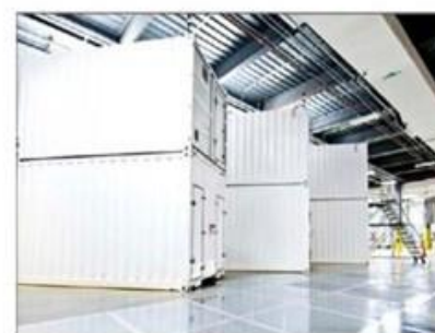
一处位于芝加哥的数据中心采用 集装箱式IT设施模块
