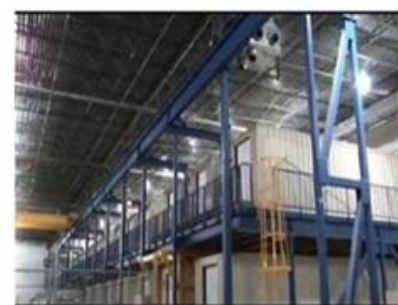
一处位于俄勒冈州的数据中心采用 集装箱式IT设施模块
